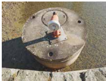
Abbildung 3: Saugschacht im Löschwasserteich - Absturzgefahr beim Übersteigen!
