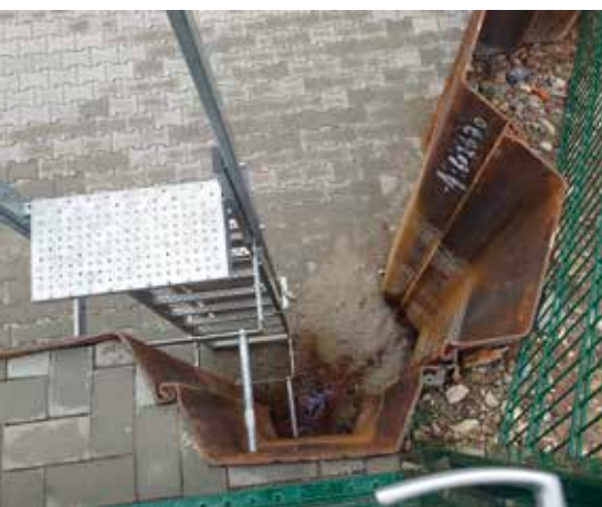
Abbildung 2: Unsicherer Stand in 2,60 m Höhe zum Aufschließen der Eingangstür FOTO: STEPHAN DECKERT / FUK MITTE
