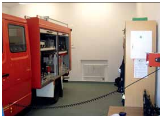
Fehlende Gefährdungsbeurteilung: Das Kabel eines Batterieladegerätes wird nicht als Stolpergefahr erkannt.
