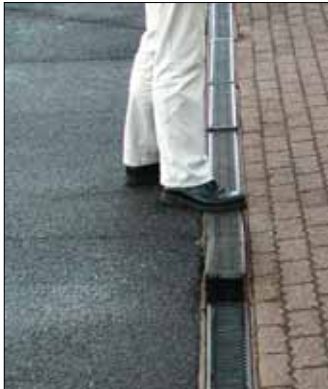
Sturzgefahr: Böse Stürze können die Folge dieser defekten Ablaufrinne sein.
