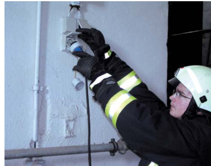
Vorsicht bei der Benutzung von unbekanntem Hausinstallations
